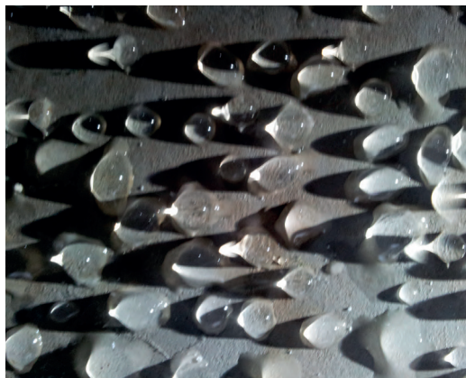
Condensación tras la puerta de acceso a la cavidad.
